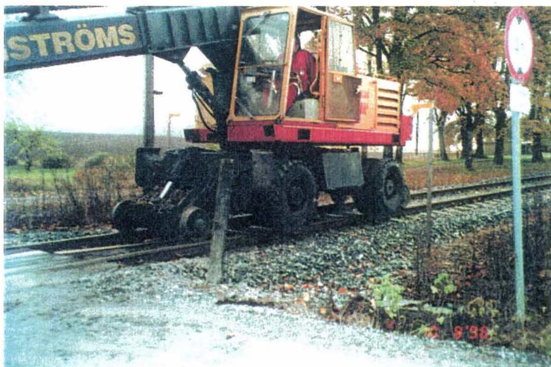
Figur 12. Jernbaneaksling for styring av gravemaskinen på skinnene. Framdrift med maskinens egne hjul.
