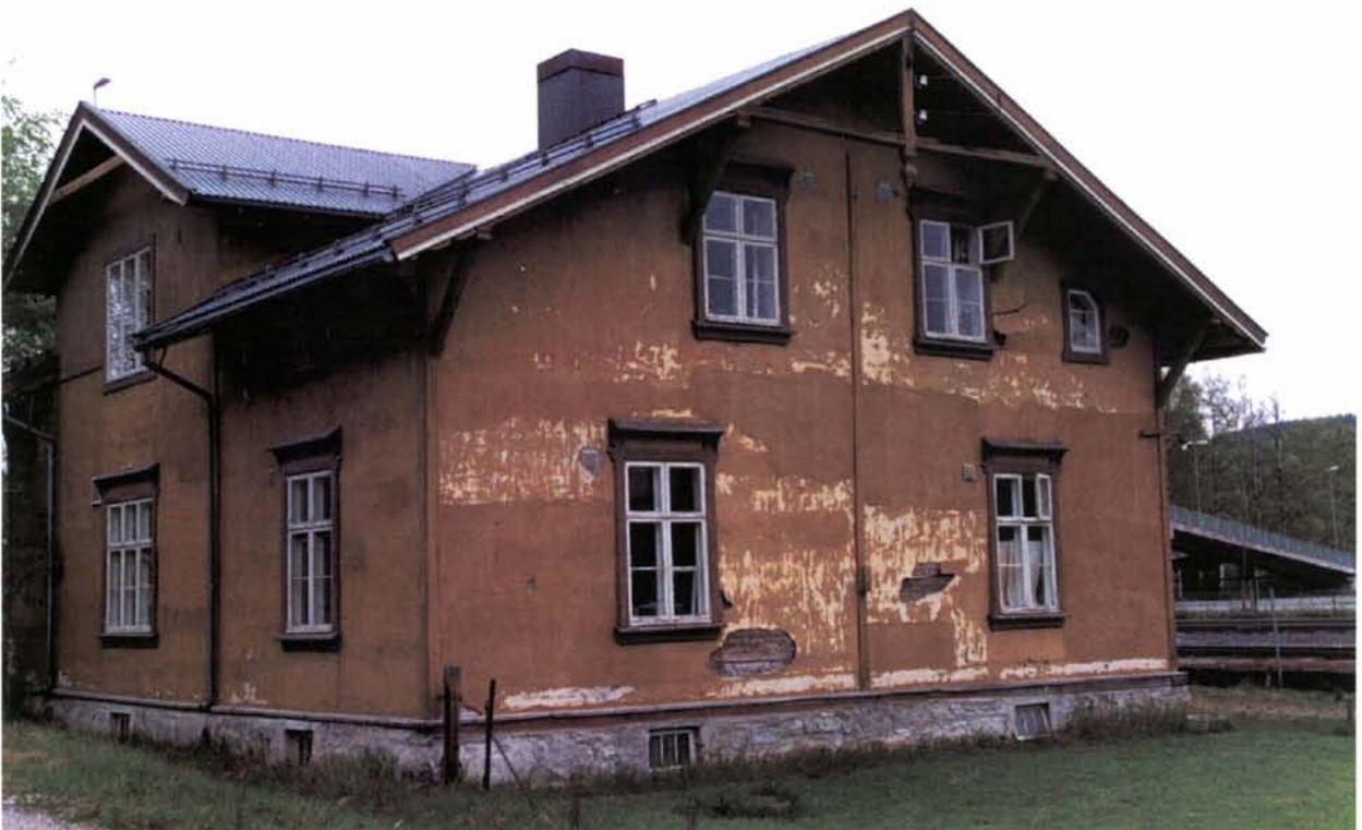
Foto 55 og 56: Vokterboligen på Rena, km 190,27, er tegnet av G. A. Bull. Uthuset (fotoet øverst) er vernet som arkitekturminne i NSB's "Verneplan for jernbanebygninger". Vernet har imidlertid liten mening om ikke også hovedbygningen tas vare på. Godt bevarte eksemplarer av disse bygningene er i dag sjeldene. Spesielt for boligen på Rena er at fasaden er rappet med murpuss.
