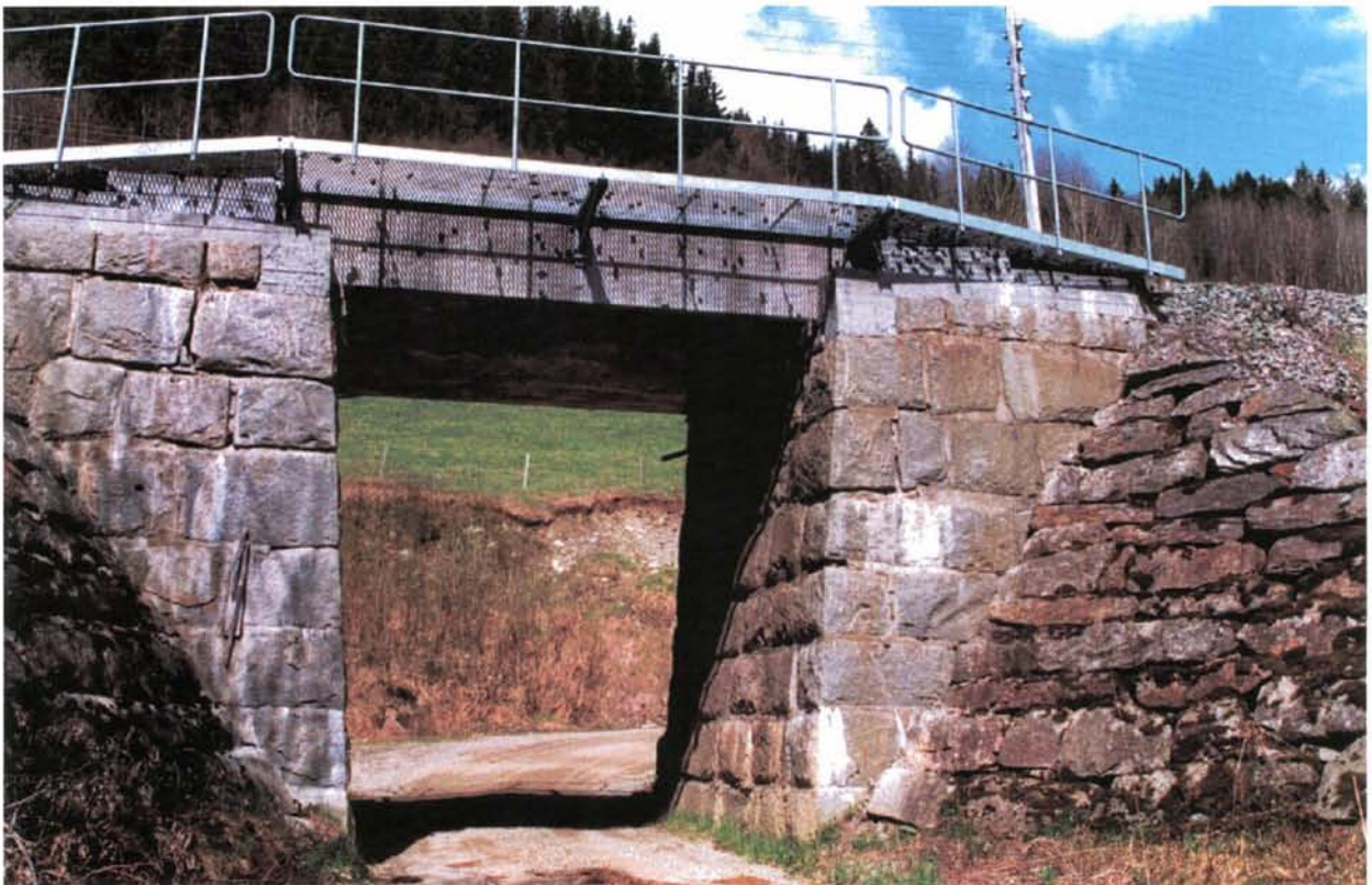
Foto 73: Slike hybridkonstruksjoner, også denne ved Gåre, uten respekt for oppgavens estetiske utfordring må det bli slutt med på jernbanenettet. Disse vil i det lange løp bidra til å sette Jernbaneverkets evne og vilje til å ta vare på gammelt, godt håndverk i et dårlig lys.
