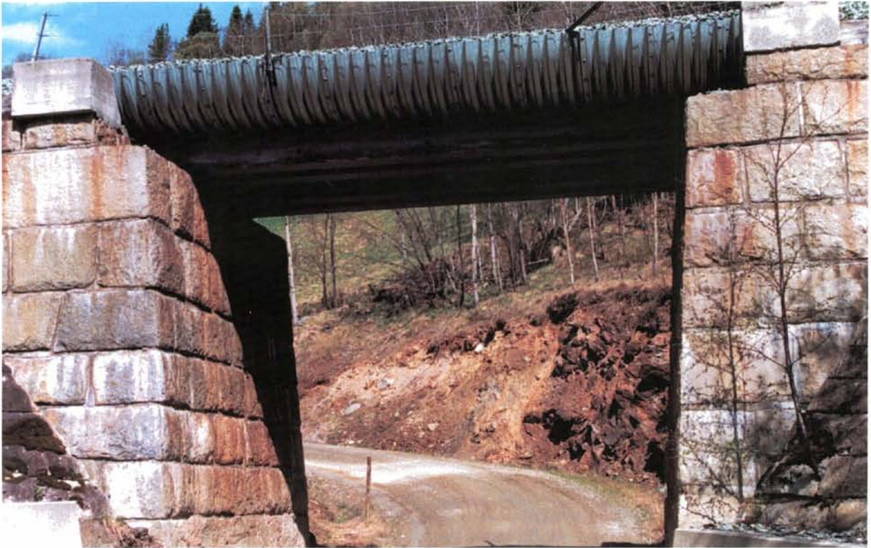
Foto 72: Trau av bølget stål ble en periode montert oppå tvillingbærerne for å kunne føre ballasten over konstruksjonen og derved tillate sporet å flyte fritt. Denne "hjemmesnekrede" løsningen ved Gåre, km 458,17, er senere forlatt til fordel for betongtrau, men løsningen kan videreutvikles gjennom bruk av selvbærende stålkasser.
