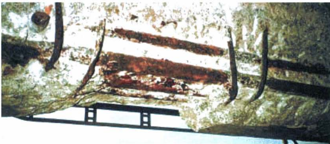
Eksempel på alvorlig skade på et bærende bruelement av betong 1
