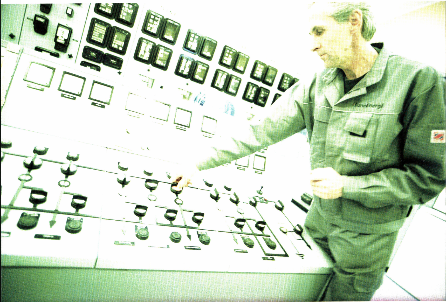
Maskinsjefassistent Terje Stø foretar styring av Asker omformerstasjon.
