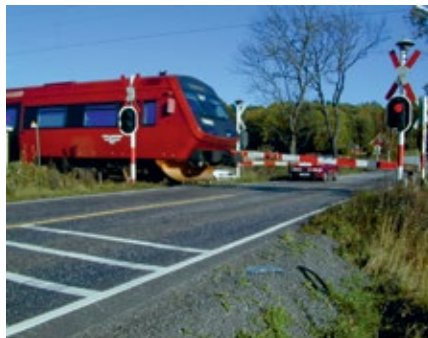
Halvbomanlegg / Half barrier
