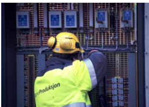
Sikringsanlegg. Foto: Rune Fossum
