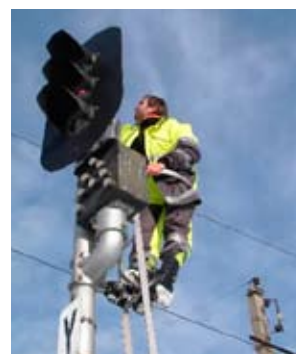
Magne Olsen arbeider på signalanlegg. Foto: Magne Hamar
