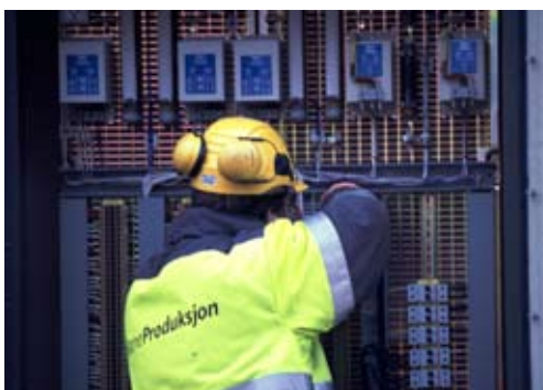
Sikringsanlegg. Foto: Rune Fossum
