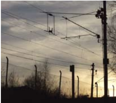
Kontaktledning. Foto: Sven Goll
