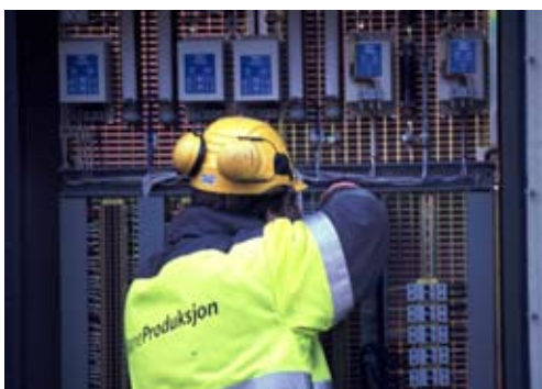
Sikringsanlegg. Foto: Rune Fossum
