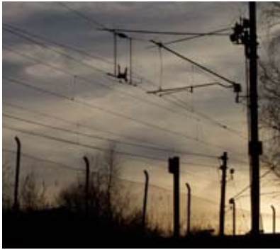
Kontaktledning. Foto: Sven Goll
